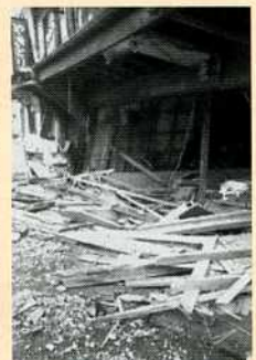
▲崩壊した家屋
